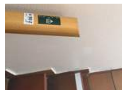
Handlauf mit Fluchtweganzeige
